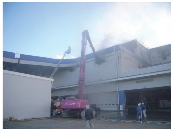
開口部破壊状況（17日17時13分頃） （入間東部地区消防組合消防本部提供）
