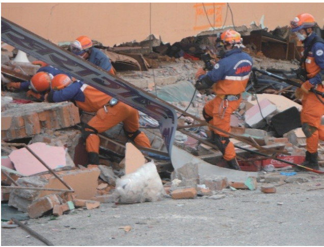
ゴンガブ地区での 1 階、2 階が座屈したホテルに おける高度救助資機材を使用した搜索救助活動 ネパール地震災害（平成 27 年 4 月派遣）
